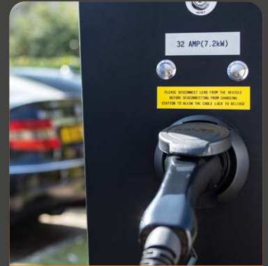
Sähköautojen lataus / Aurinkoenergia
