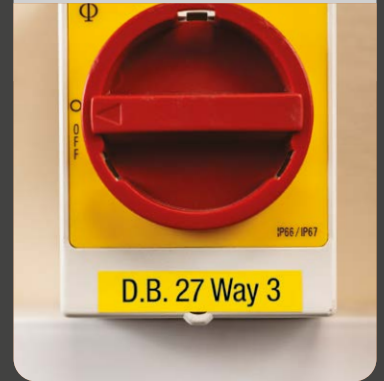
Ohjauslaitteet ja kytkinlaitteet
