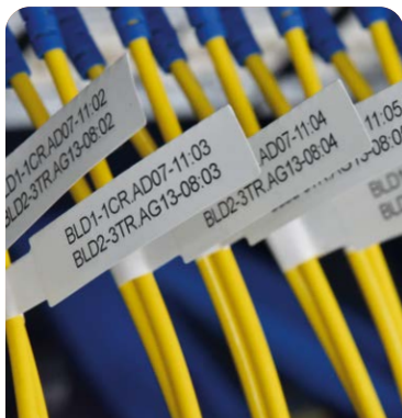
Cable ID - Fibre
