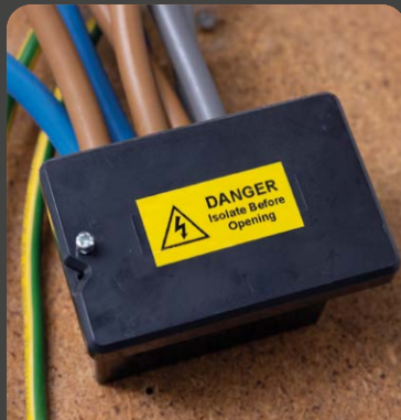
Electrical trunking / conduits
